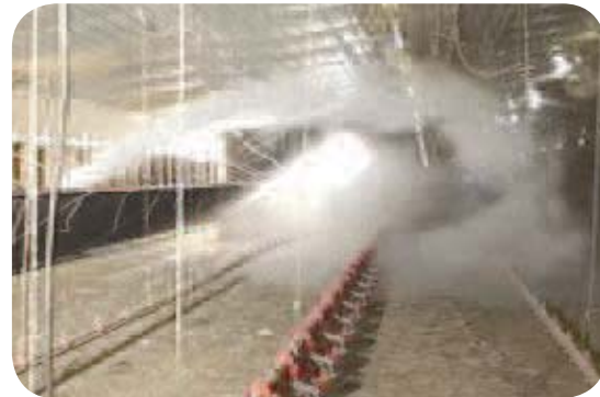
El aire se dirige hacia arriba y luego baja y se arremolina alrededor del centro del galpón para proporcionar una excepcional mezcla de aire
